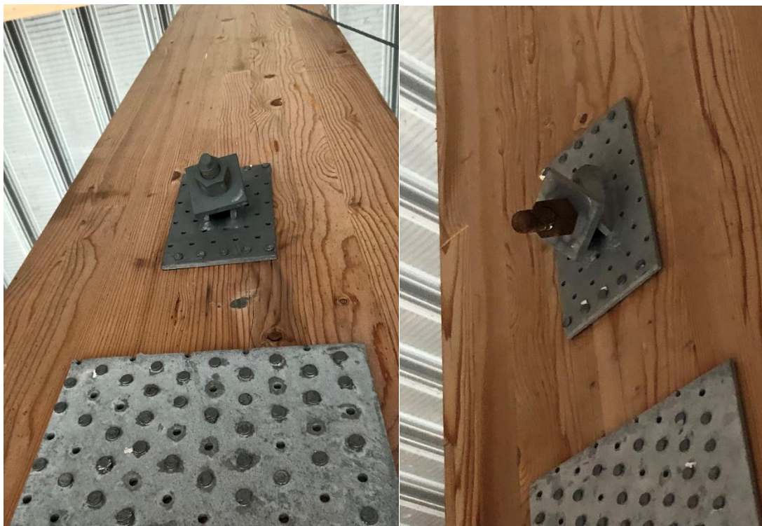
Bild 3 och 4. Infästning av stag med erforderligt rostskydd (tv) och bristfälligt rostskydd (th)
